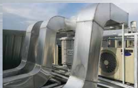
ระบบระบายอากาศ
