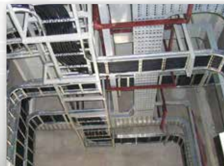
ระบบไฟฟ้าโรงงาน
