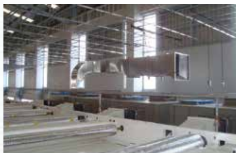
ระบบระบายอากาศ
